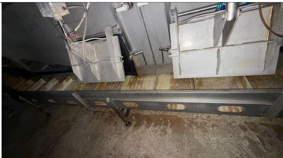
ДАЛУ.892.01.000 Конвейер подбункерный, инв. № FM-000196 залог 1
